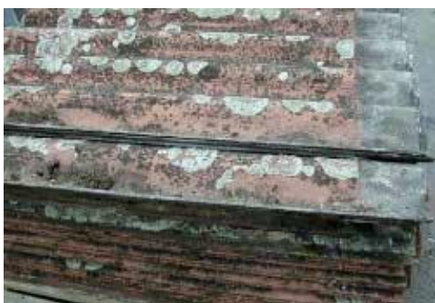
Figuur 8: asbesthoudende golfplaten
