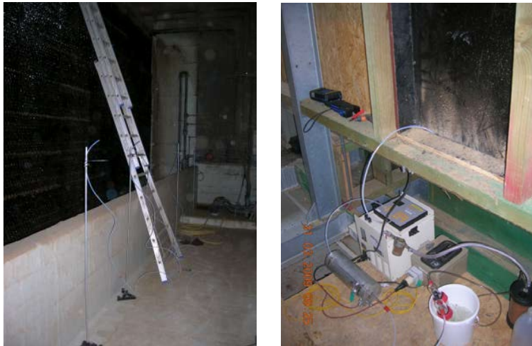
Figuur 7: NH 3 -metingen in de ventilatielucht aan de ingang van de luchtwasser
