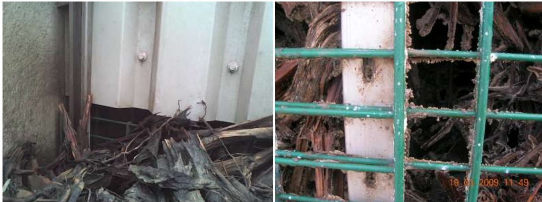
Figuur 1: Gaten in de luchtwasser
