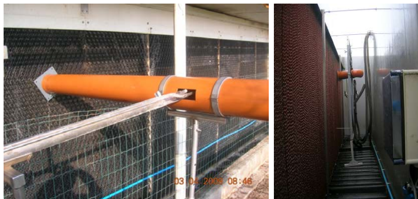
Figuur 11: Meting van de ventilatielucht aan het oppervlak van de luchtwasser met behulp van een opzetstuk
