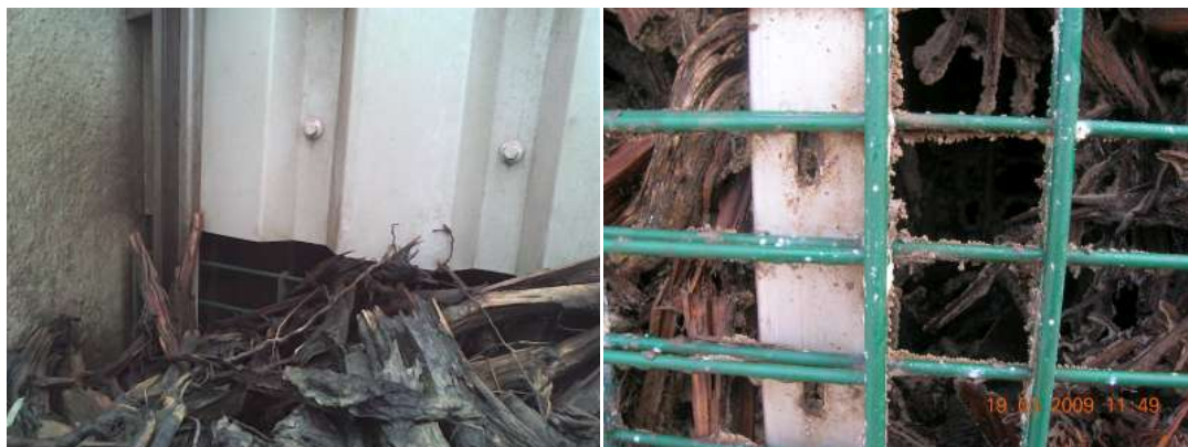
Figuur 1: Gaten in de luchtwasser
