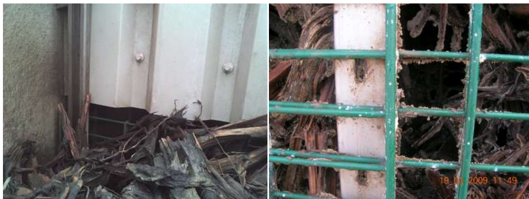
Figuur 1: Gaten in de luchtwasser
