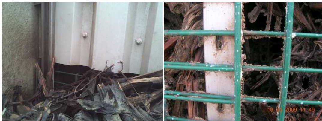
Figuur 1: Gaten in de luchtwasser
