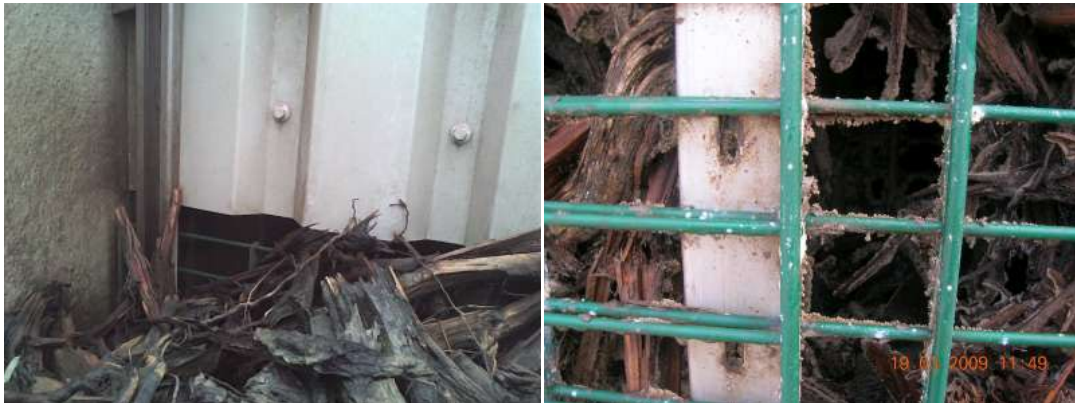
Figuur 1: Gaten in de luchtwasser
