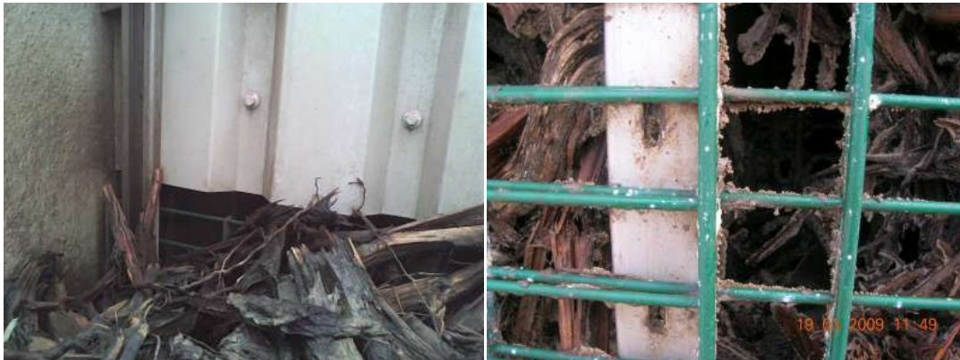
Figuur 1: Gaten in de luchtwasser
