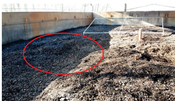
Figuur 14: Verzakking achter meetpunt 7
