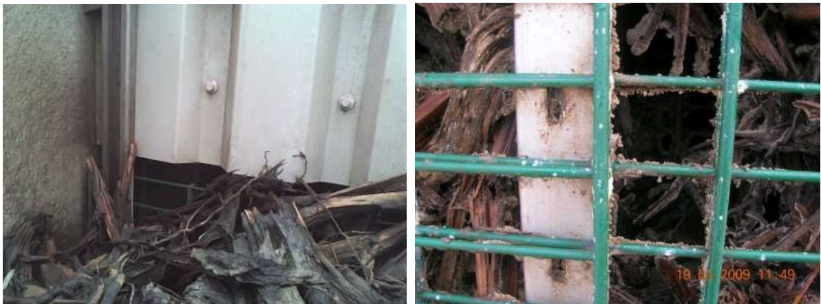
Figuur 1: Gaten in het bio-bed luchtzuiveringssysteem
