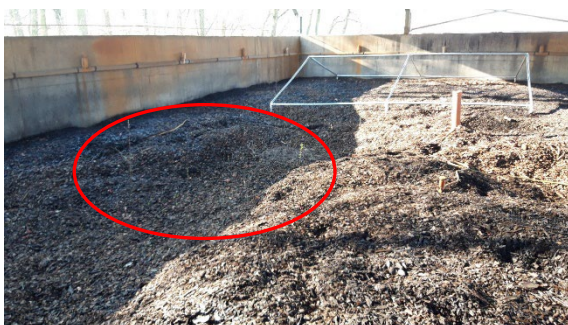
Figuur 14: Verzakking achter meetpunt 7
