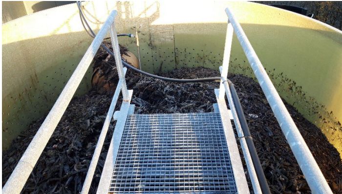
Figuur 38: Bovenzijde biofilter
