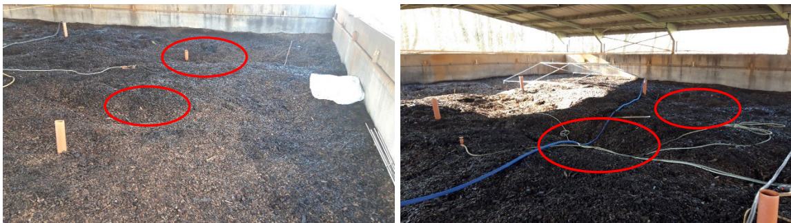
Figuur 13: Verzakkingen ter hoogte van meetpunt 4 (links) en tussen meetpunten 1, 2, 5 en 6 (rechts)
