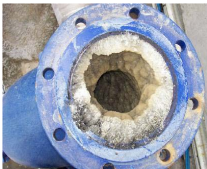
Figuur 3 Ongewenst struvietvorming in leidingen
