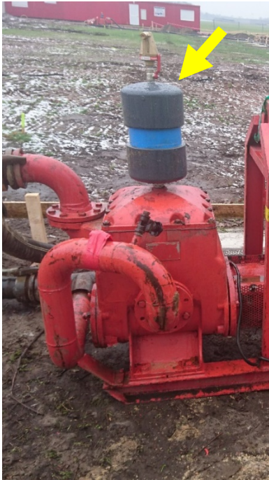
Figuur 13: bemaling waarbij de ontluchting op de pomp is voorzien (gele pijl)
