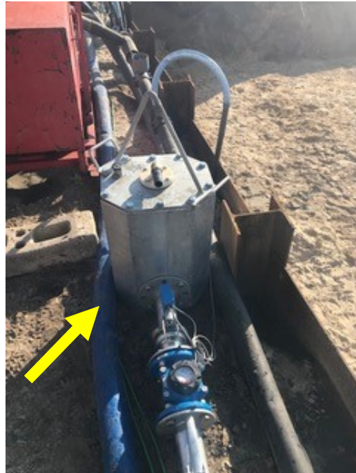
Figuur 14: bemaling waarbij een snelontluchter (gele pijl) voor de watermeter werd geïnstalleerd. Er is geen gepast leidinglengte voor de meter, en er is diameterverloop in de aanvoerleiding kortbij de watermeter
